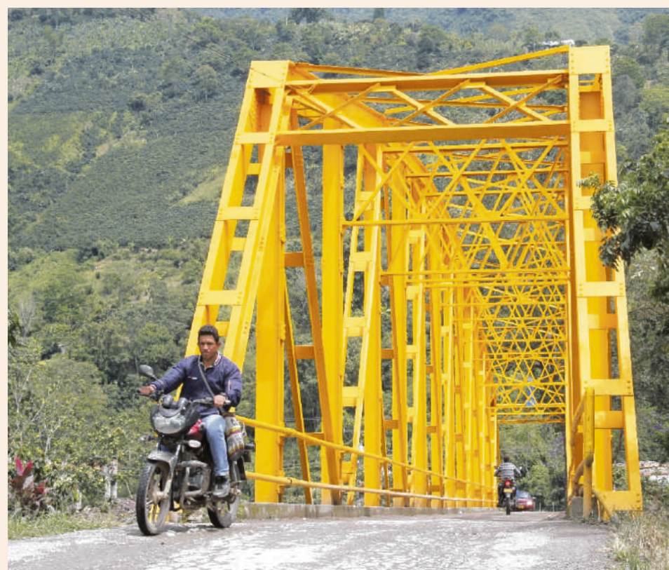
El gobernador del Huila, Ingeniero Luis Enrique Dussán López, a través de la Secretaría de Vías e Infraestructura intervino el Puente Ortiguaz, para embellecerlo y realizar trabajos de rehabilitación que permitieron mejorar la movilidad y llevar bienestar a los habitantes de los municipios y veredas vecinas de Elías, Saladoblanco y Oporapa.
