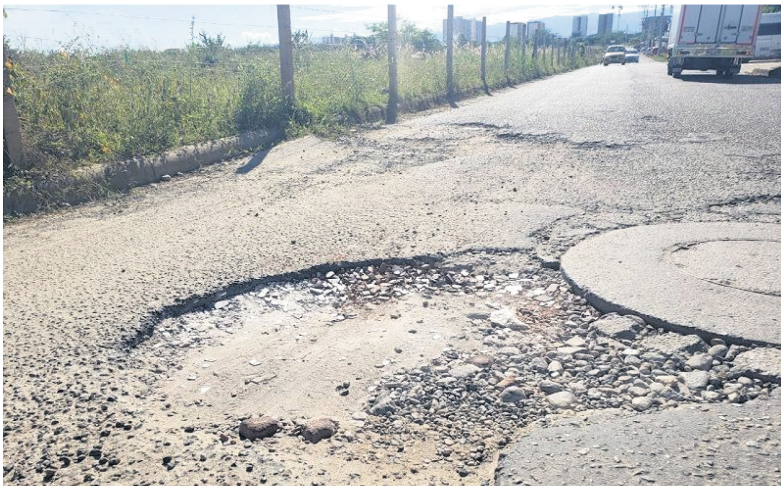
Las vías en mal estado, dañan los carros.
