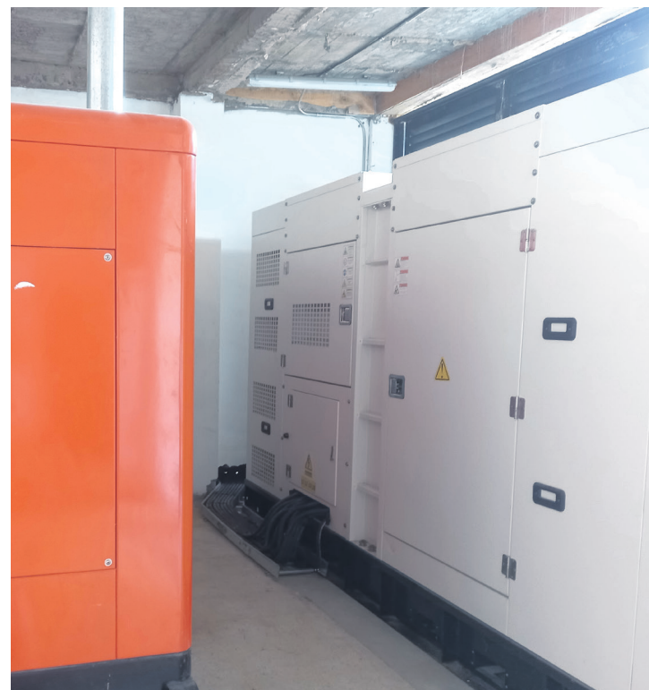
La planta eléctrica que garantizará el suministro de energía ya fue instalada.
