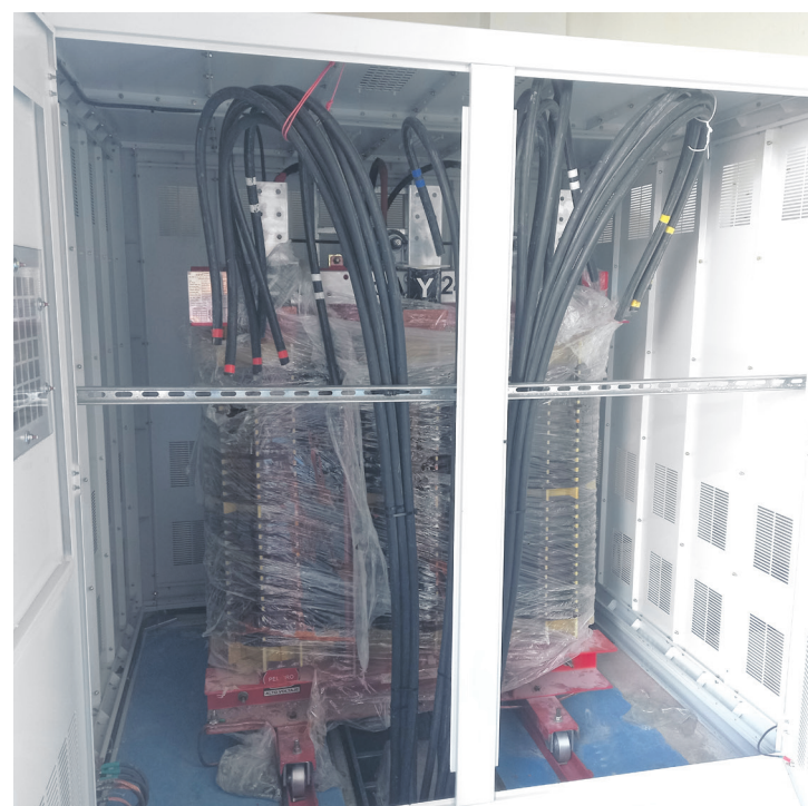
Los transformadores de última tecnología y con la capacidad necesaria fueron importados y ya están totalmente instalados.
