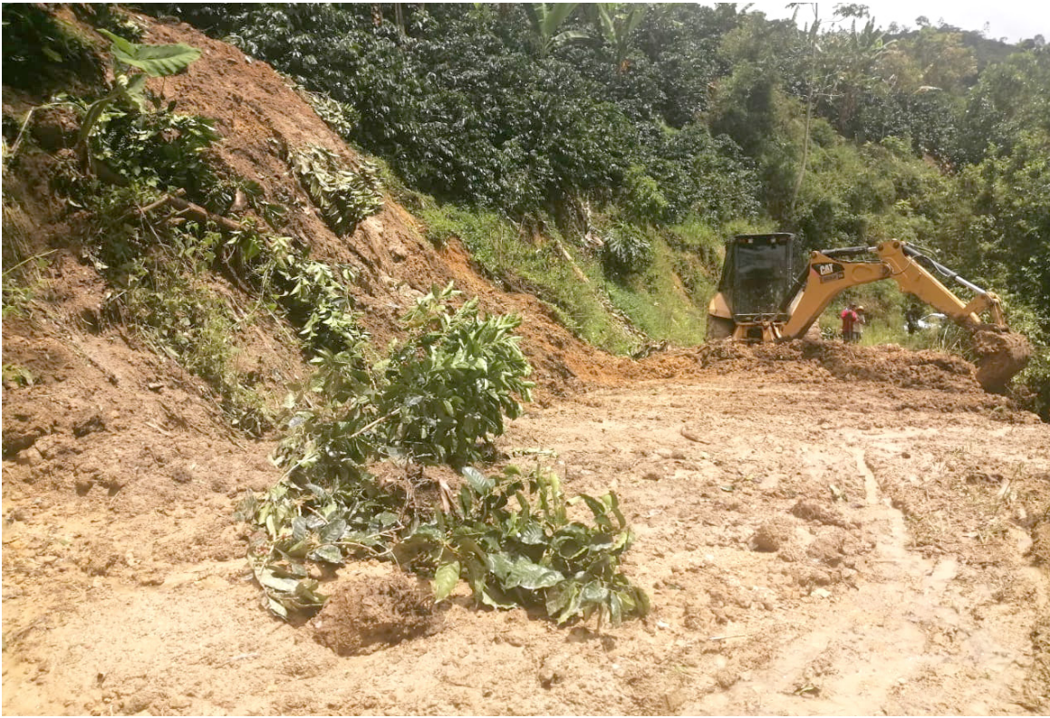
Íquira fue uno de los municipios más afectados con deslizamiento con afectación en vías rurales.
