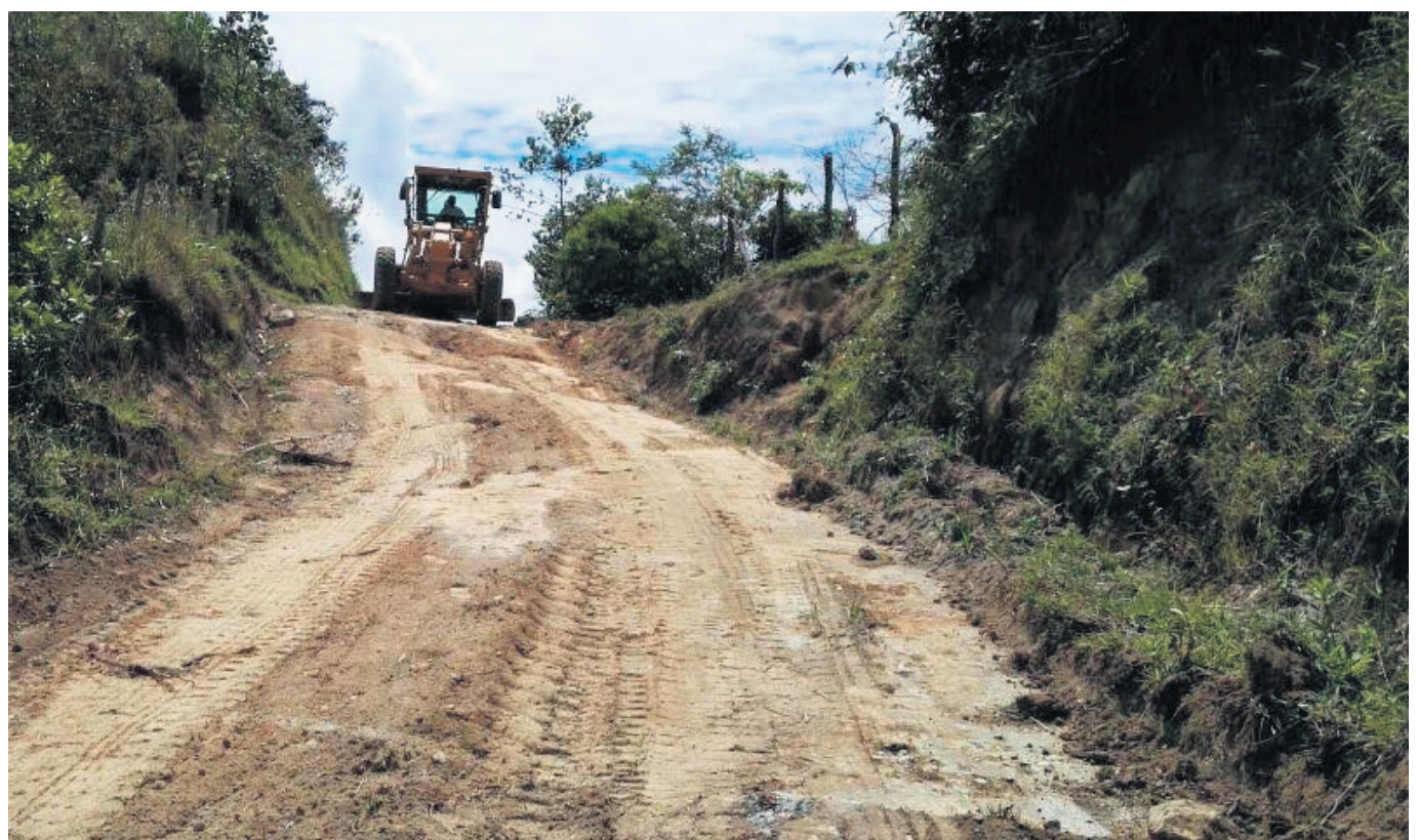
47 vías rurales presentan daños.
