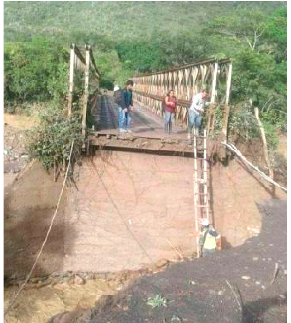
Puente 'El Totumo' afectado por el río.
