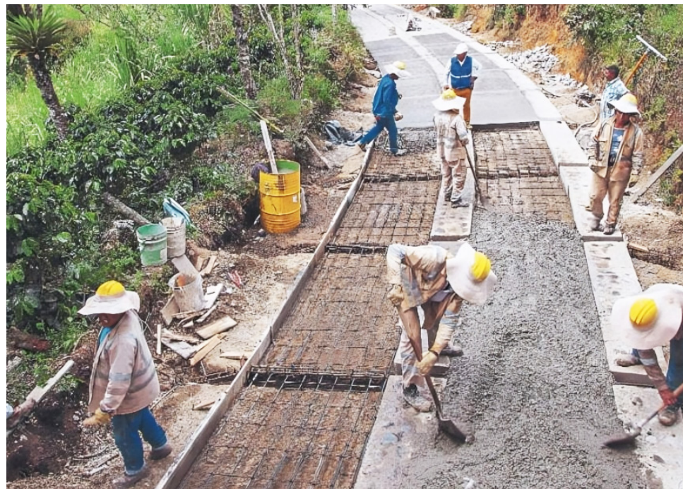
También, se vieron afectadas las obras de puentes en vías terciarias en Nariño.
