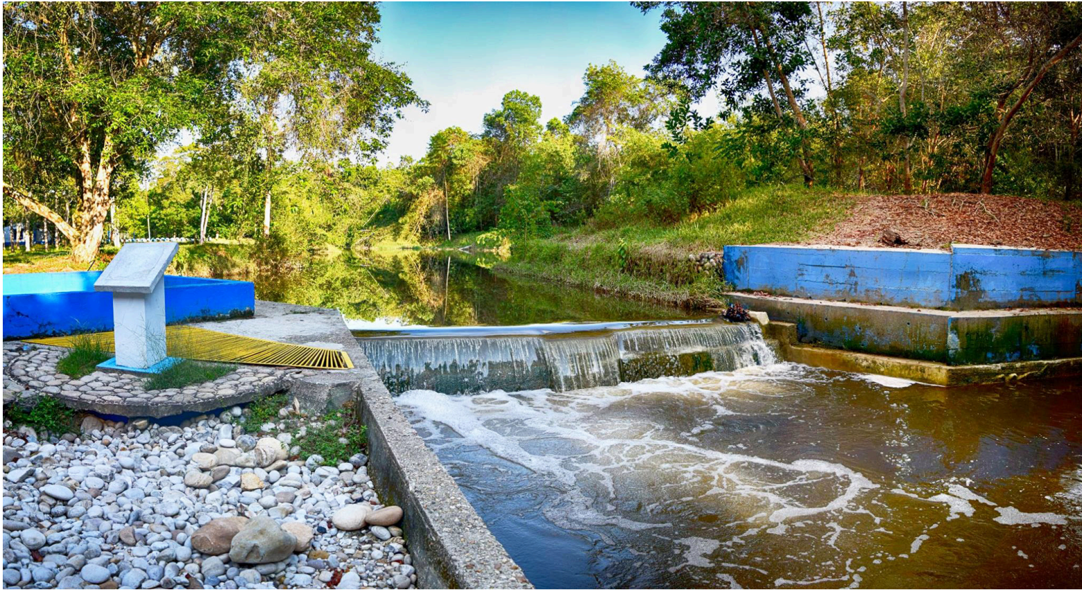
Entre las obras afectadas está a construcción de un acueducto en la zona rural de Sabana de Torres, Santander.
