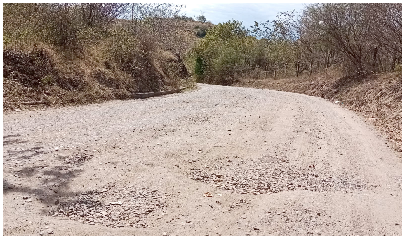
La comunidad exige la pavimentación de la vía.
