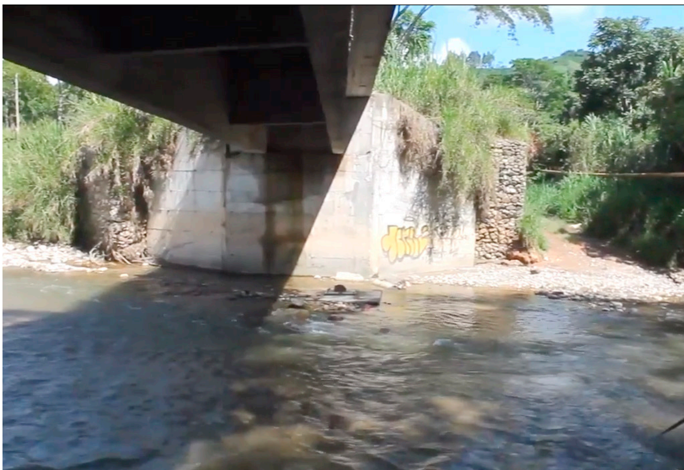
En el puente sobre el río Guarapas, se plantea su reestructuración y ampliación para garantizar una infraestructura vial a la altura de la movilidad regional.
