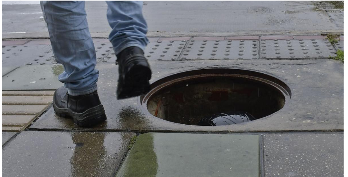
Instalaron 10 tapas de alcantarilla en la comuna seis de la ciudad, de las cuales se perdieron 8 en el primer fin de semana.
