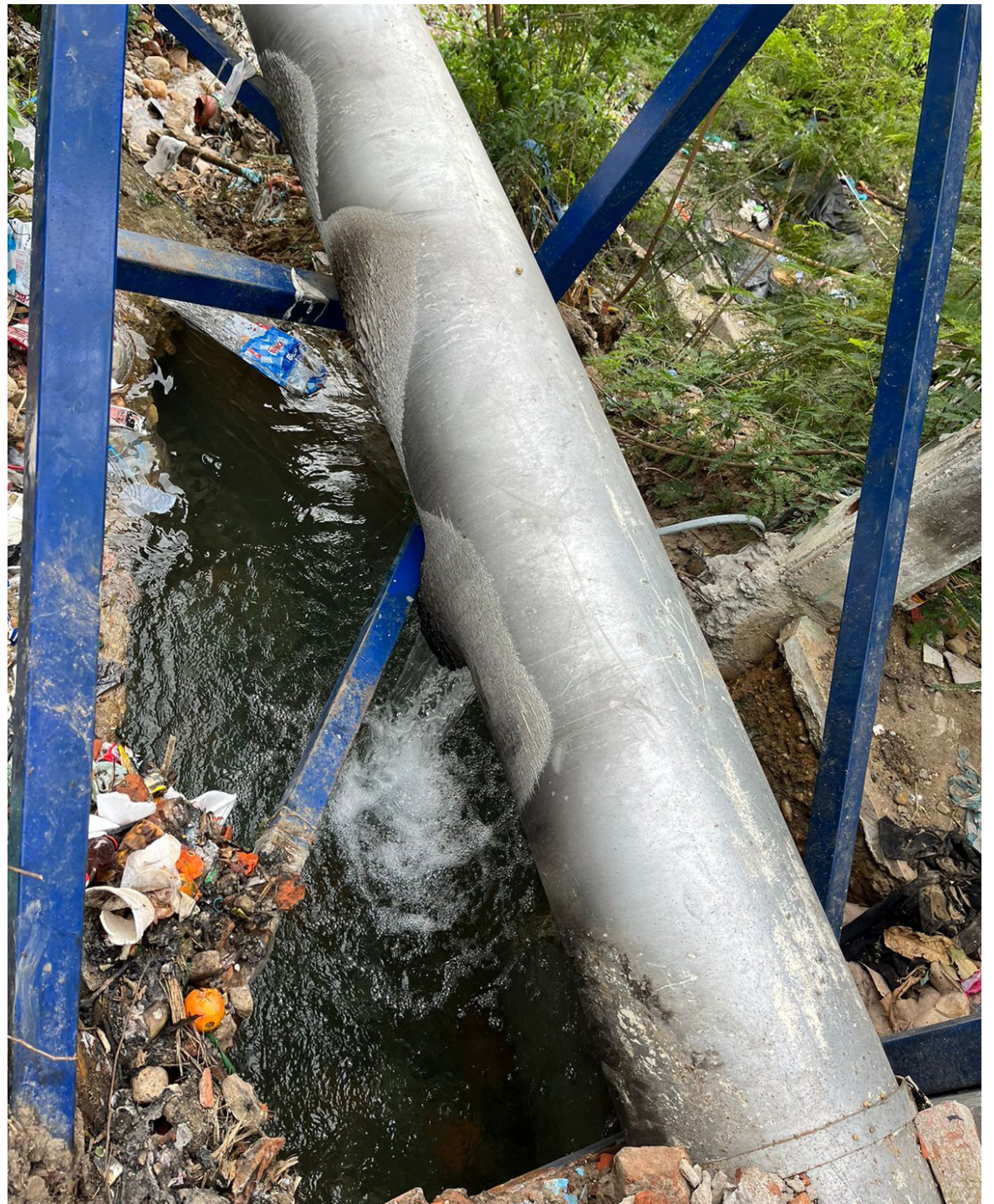
El arreglo del tubo que fue quemado entre los barrios Bogotá y San Martín, tiene un costo de $5 millones.
