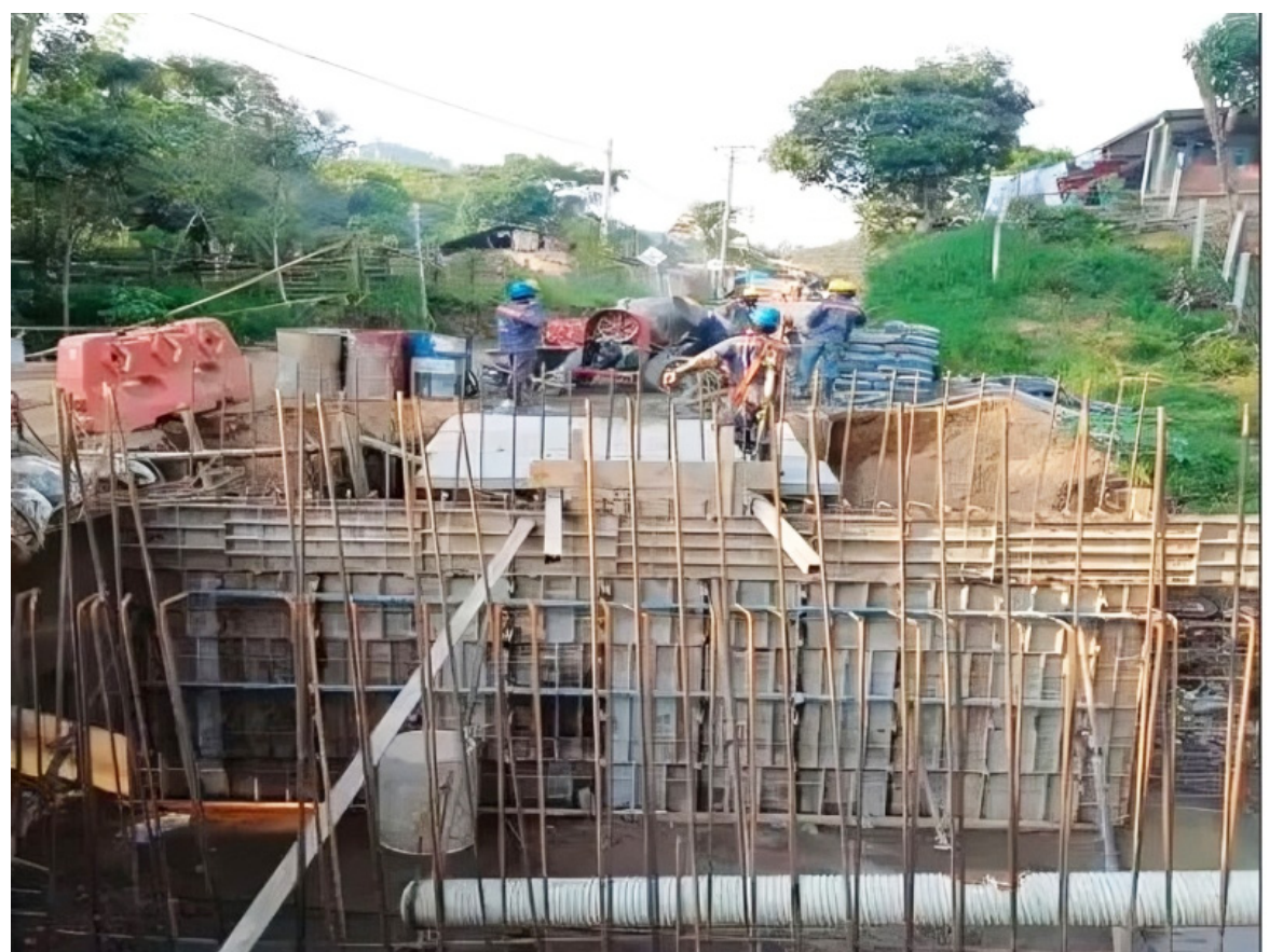
La obra ha progresado adecuadamente en explanación de la vía, afirmación de bases y subbases, entre otros.
