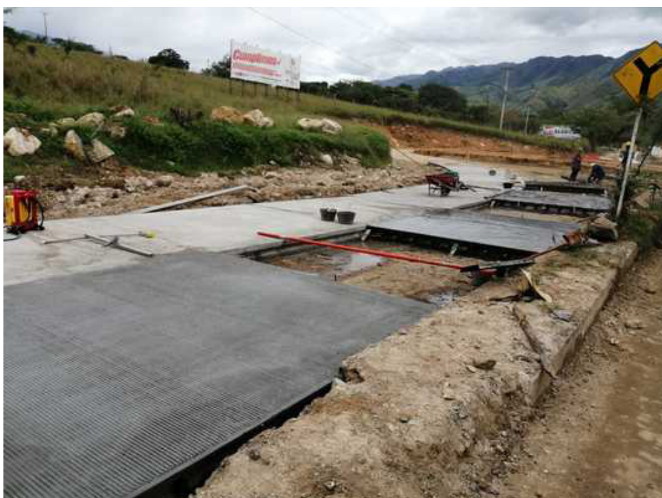
La vía que comunica a Algeciras, tuvo un problema de diseño, que ya se encuentran corrigiendo.
