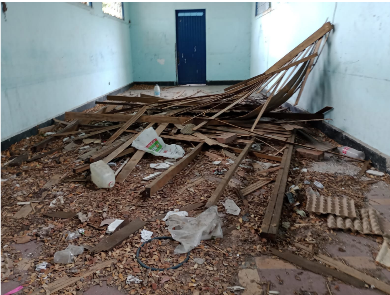
De no ser intervenido a tiempo esta locación, ya no se podría recuperar.
