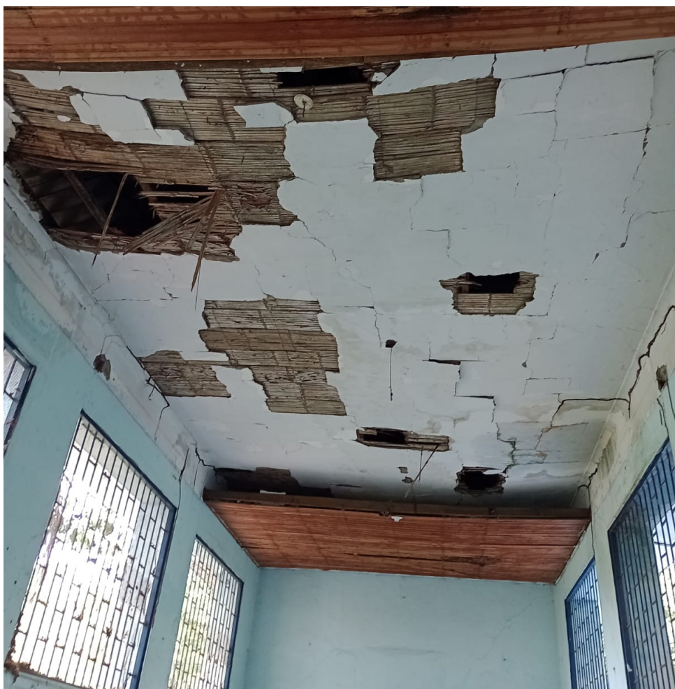
El bloque ‘C’ está aislado y se deteriora cada día más.
