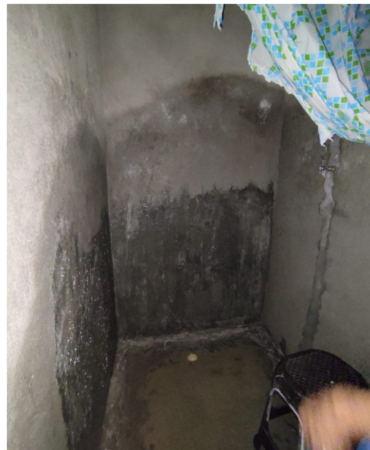
Las instalaciones del centro transitorio muestran signos de deterioro y falta de mantenimiento, contribuyendo a un ambiente insalubre para los detenidos.
