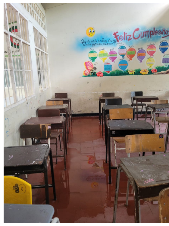
El Colegio Ecopetrol, tiene aulas que se inundan cuando hay lluvias.
