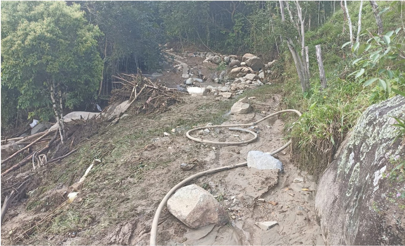
Tres veredas quedaron sin acueducto.
