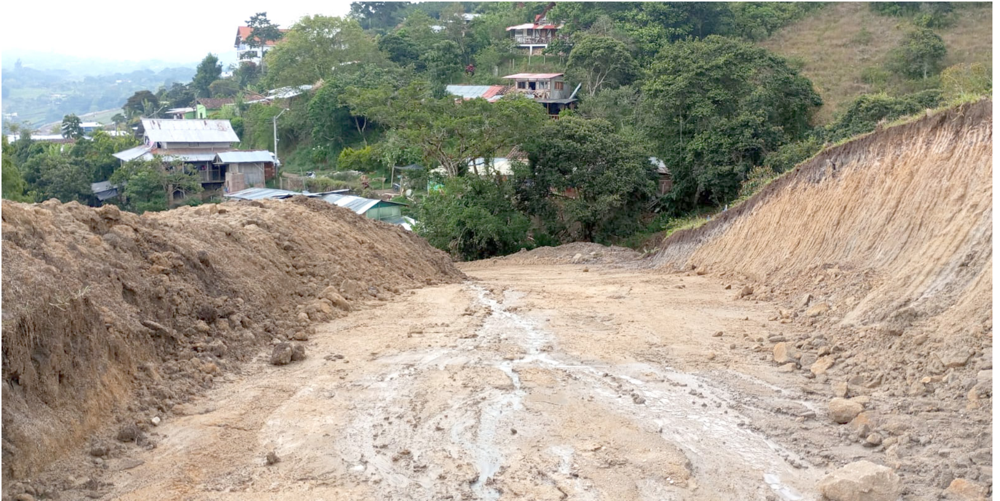
Sector afectado por los residuos de a construcción de la circunvalar en San Agustín.
