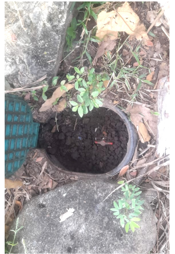
Así se encuentran los micromedidores instalados en las viviendas de los 80 usuarios que habitan en la vereda del Bajo Mirador, Yaguará.
