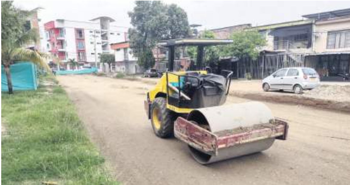
Compactadora en la intervención de la calle 51 en el norte de Neiva.
