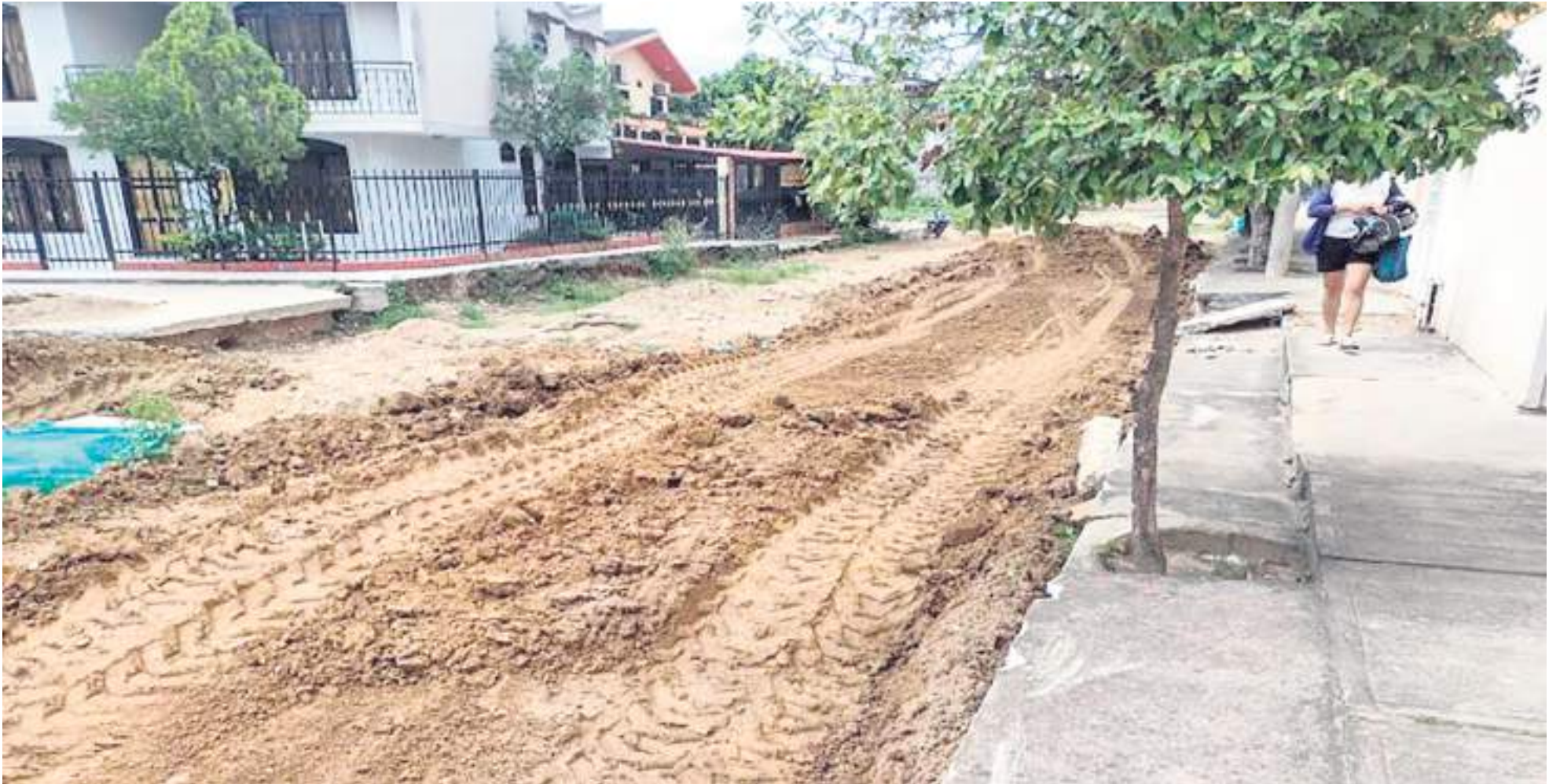
Trabajos de alistado de la calle 51 en el sector de Álamos Norte.
