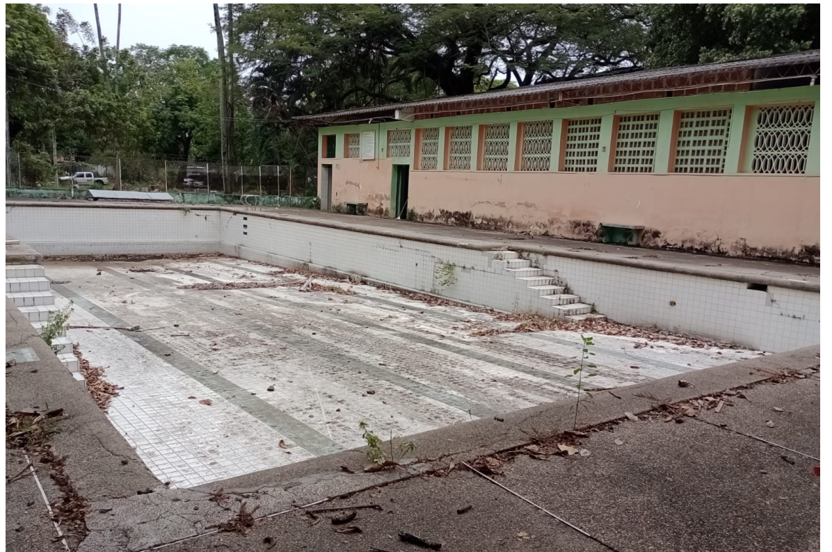
El bloque ‘C’ y la piscina se encuentran abandonados.
