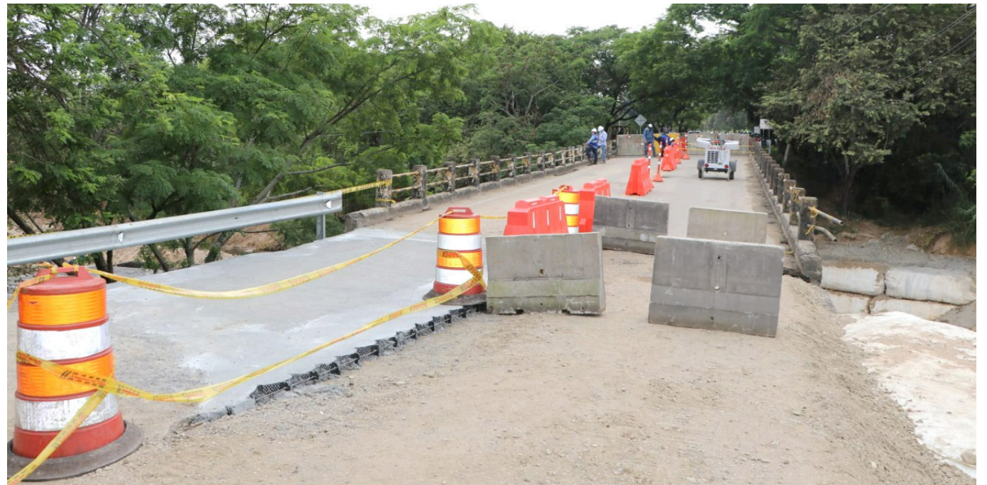
Puente arenoso con dificultades por predios
