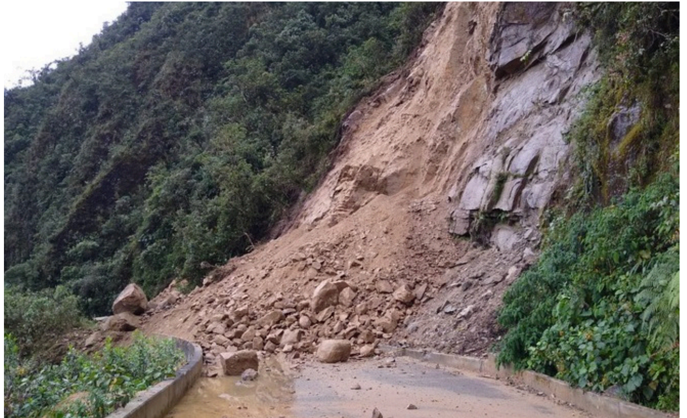
El municipio de Santa María, resultó afectado por las lluvias que derivaron en deslizamientos.
