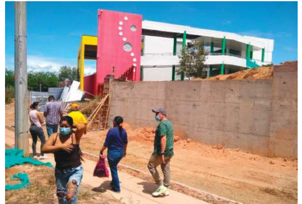
El muro colapsado en el sector sur ha sido una de las obras recuperadas
