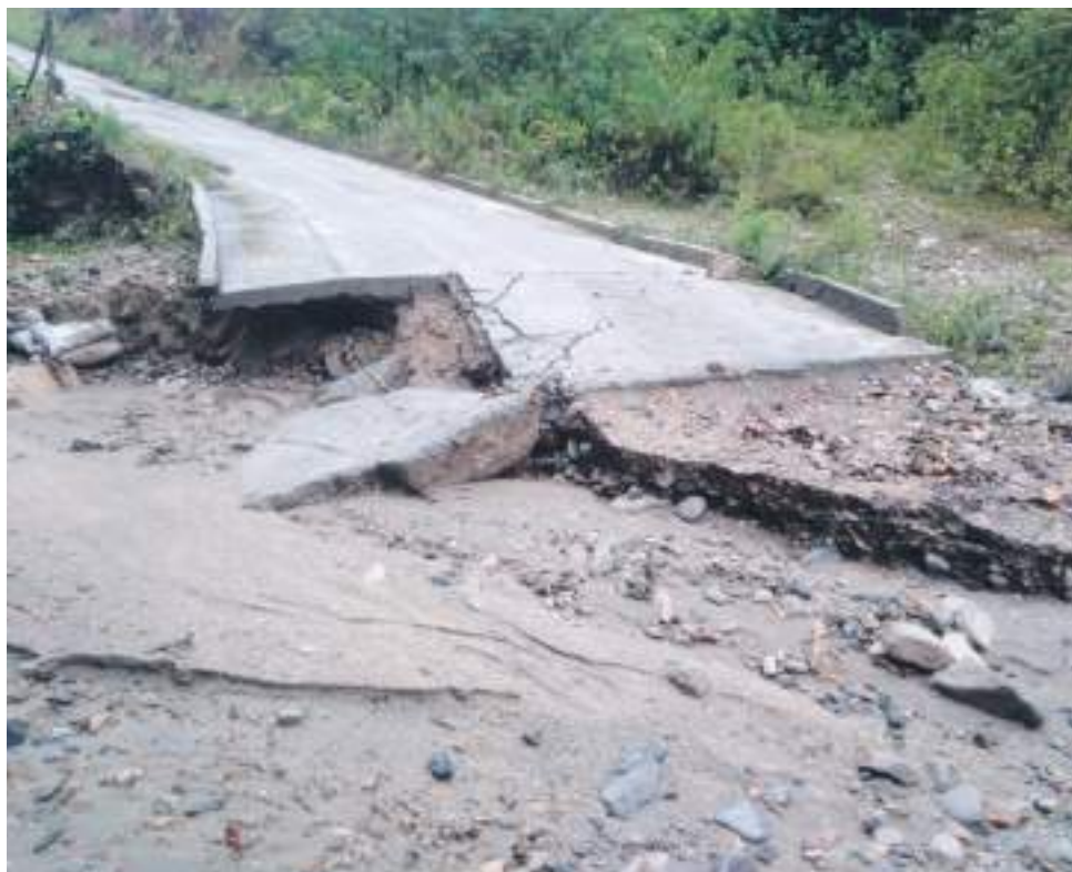
Se han notificado 5 vías afectadas.
