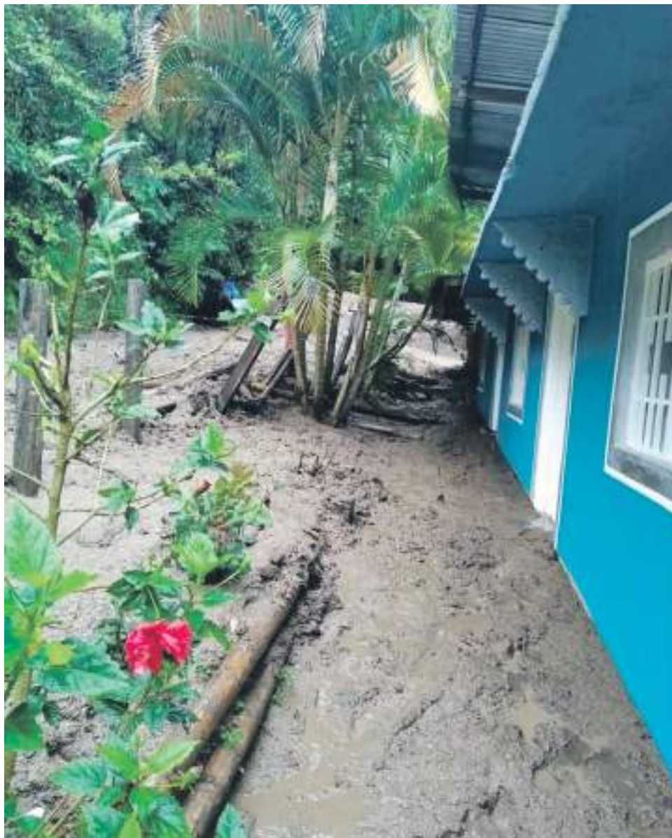
Daño en una casa, ubicada en el municipio de Santa María.
