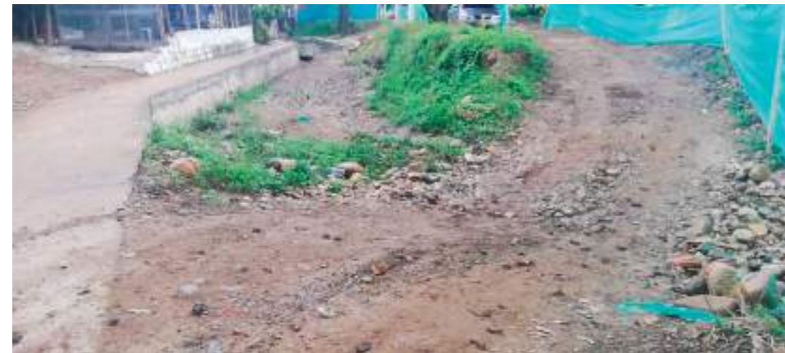
Una de las peticiones tiene que ver con el arreglo de la vía de acceso en mal estado.
